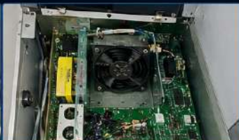
REVISIÓN Y LIMPIEZA DE FUENTES Y VENTILADORES
