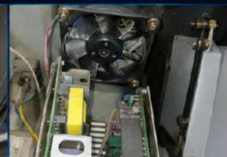
REVISIÓN Y LIMPIEZA DE FUENTES Y VENTILADORES
